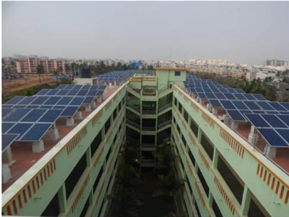
Vagdevi Villas - 100KWp
